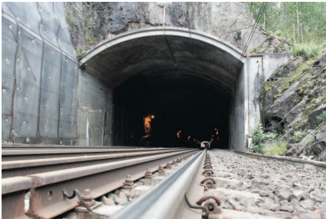
Tågtrafiken i de tre bergtunnelarna vid Graversfors bör stängas enligt en konsultrapport. Men Banverket menar att det inte finns någon anledning till oro just nu. Efter sommaren byggs tunnelarna om.
