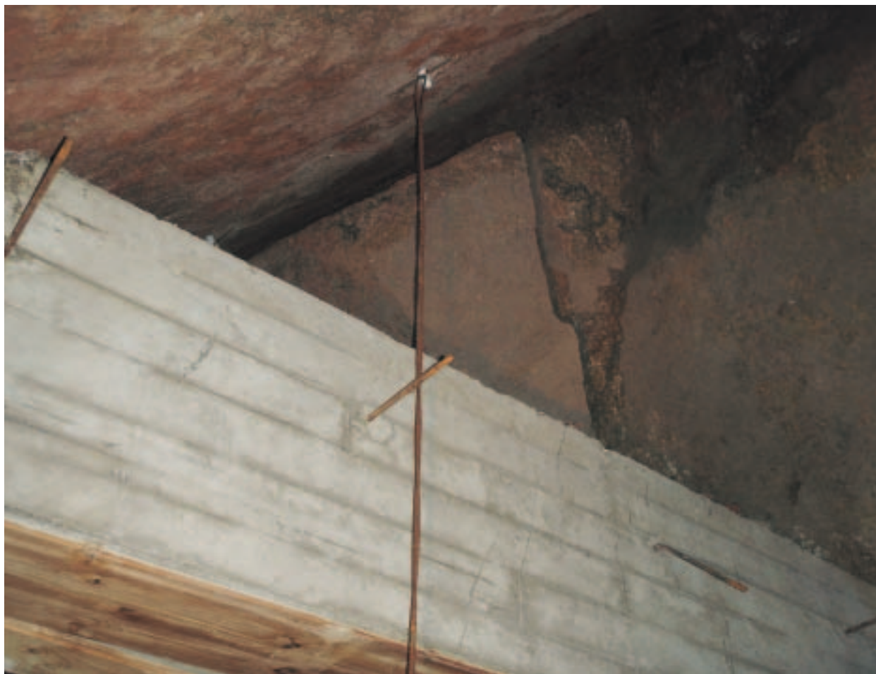
Här är en av de betongbalkar som Banverket känner stor oro för. På just den här balken vilar dessutom ett större bergblock vilket ytterligare ökar belastningen på balken.
