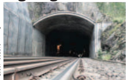
Tågtrafiken i de tre bergtunnelarna vid Graversfors bör stängas enligt en konsultrapport. Men Banverket menar att det inte finns någon anledning till oro just nu. Efter sommaren byggs tunnelarna om.
